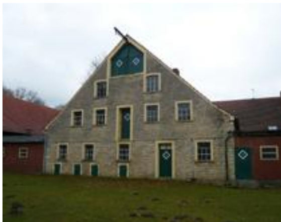
Der Giebel des alten Schweinestalls vor dem Umbau. Links und rechts sind nun abgerissene Stalltrakte zu sehen.
